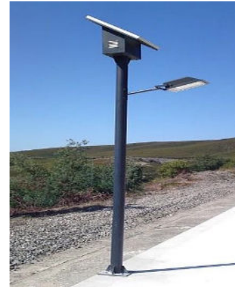
Exemple de lampadaire « écologique », éclairage dirigé vers le bas, avec détecteur de mouvement et panneau solaire
